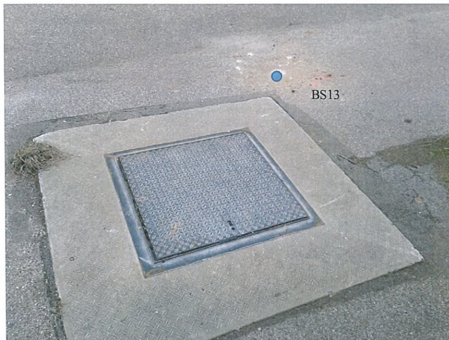
Foto 6: Domschacht Altöltank vor Werkstatt (Bohrung BS13)
