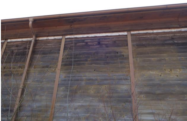
Abb. 25: An der flächigen Außenverkleidung sind keine für Fledermäuse nutzbaren Quartierstrukturen vorhanden.
