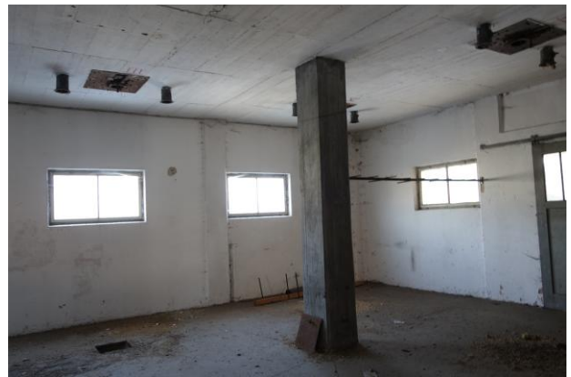
Abb. 16: Saatgutlager Erdgeschoss. Keine geeigneten Strukturen für Hangplätze vorhanden.
