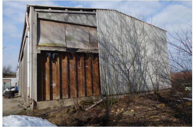
Abb. 28: Teile der Verkleidung sind abgebrochen.
