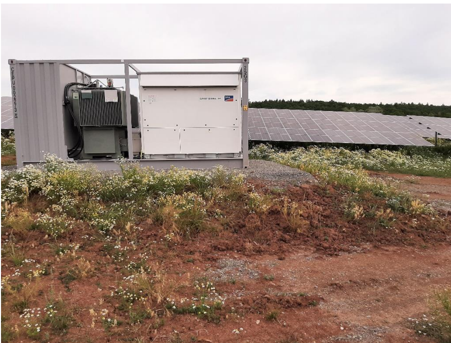
PV-Anlage Bundorf, 27.6.2023: Möglichkeiten zur Anlage von kleinen Steilwänden und Abbruchkanten bieten die Aufschüttungen für die Transformatoren-Häuschen
